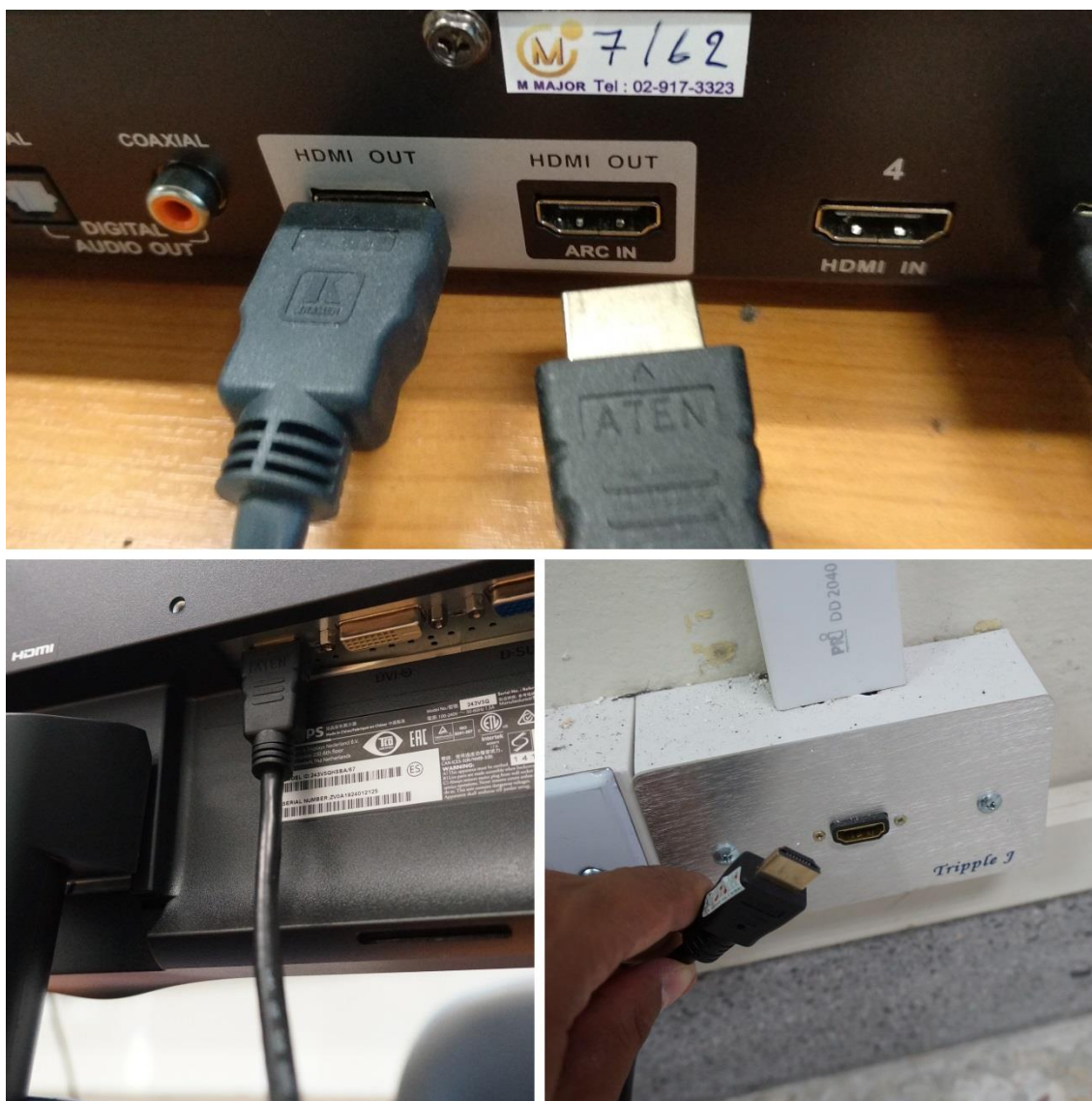
ภาพที่ 4.24 การต่อสายสัญญาณจากเครื่องเลือกสัญญาณภาพไปยังจอคอมพิวเตอร์และได้รับสัญญาณภาพ HDMI ของเครื่องฉายภาพโปรเจคเตอร์
