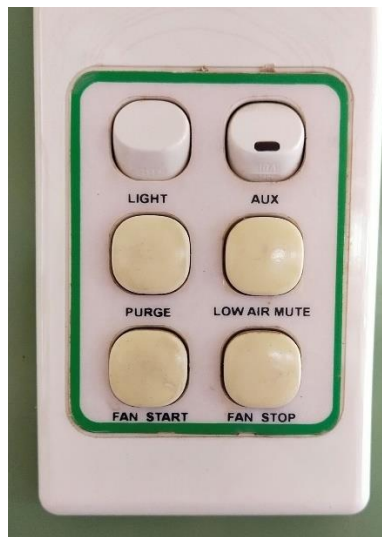
รูปที่ 34 ปุ่มกด และแผงควบคุมของตู้ดูดควัน (Fume hood) (Wiwatsan Lab)
